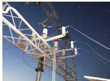
Пункты коммерческого учета на опорах ВЛ 6-35кВ
