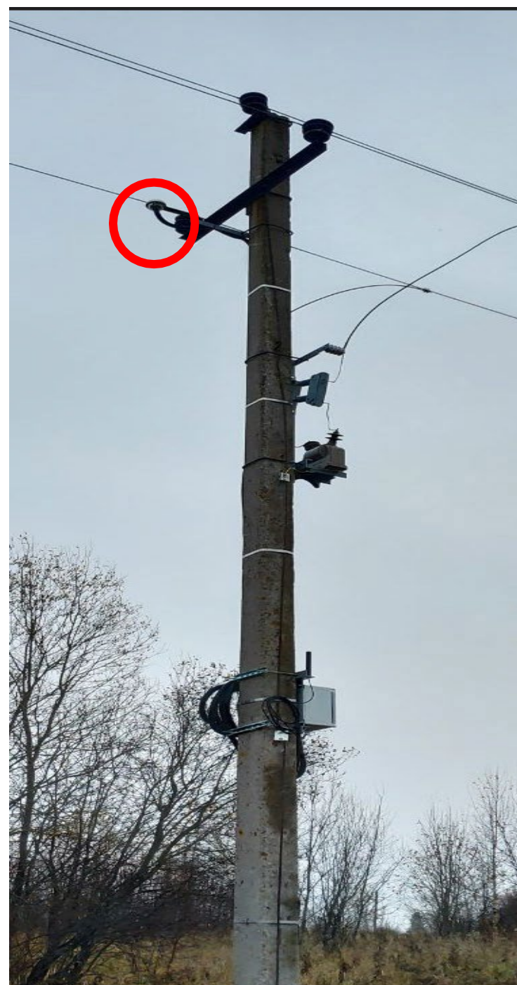
ИСЛ на опоре
